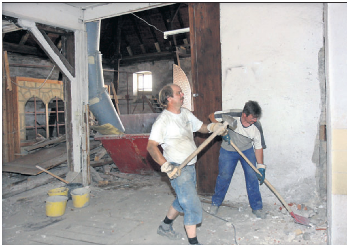
Die Ausräumarbeiten in der Glockenkelter haben begonnen. Im Bild Eberhard Siegle und Thorsten Hedler gestern beim Ausbeinen der historischen Kelter. Bild: Pavlovič
